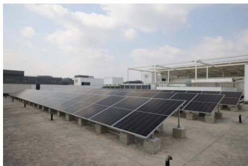
屋顶太阳能光伏
